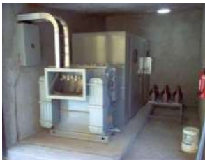
EQUIPOS EN MEDIA TENSION
