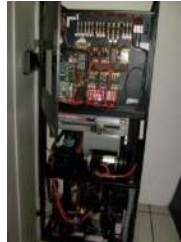
EQUIPO DE PRECISION DE 5 TON. REFRIGERACION
