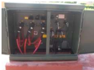
TRANSFORMADOR TIPO PEDESTAL
