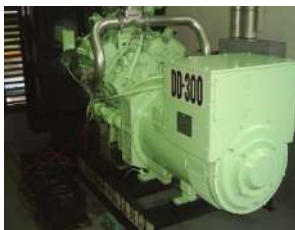
PLANTA DE EMERGENCIA A DIESEL
