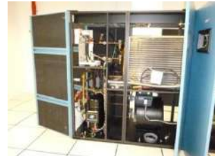
EQUIPO DE PRECISION DE 10 TON. REFRIGERACION
