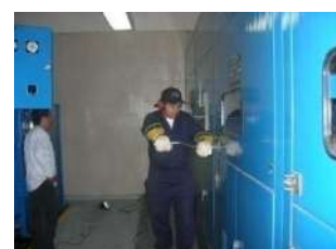
CIERRE DE INTERRUPTOR
