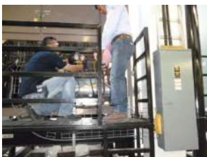
CARGA DE GAS TIPO R - 22 A EQUIPO CHILLER
