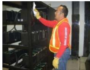
LIMPIEZA DE BANCOS DE BATERIAS
