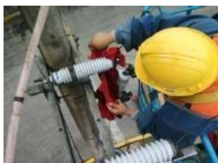
LIMPIEZA DE AISLADORES
