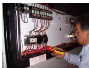
VERIFICACION DE CONSUMOS
