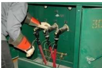
TRANSFORMADOR TIPO PEDESTAL
