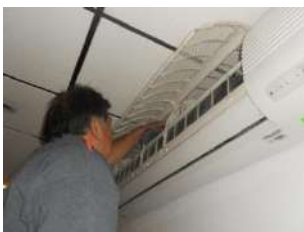
EQUIPO MINISPLIT 3 TON. REFRIGERACION
