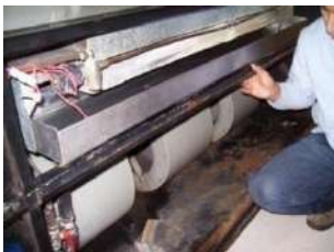
FALTA DE MANTENIMIENTO
