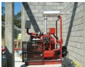
EQUIPO VS INCENDIO
