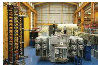
TRANSFORMADOR DE POTENCIA
