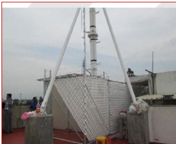
SITIO HAUYAMILPAS, MEXICO D.F... CONSTRUCCIÓN DE SITIO CON TORRE MINIPOLO EN AZOTEA
